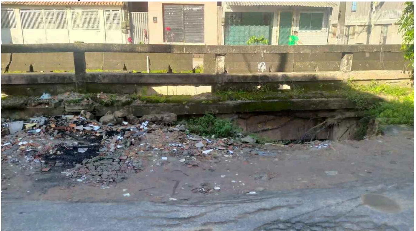
FIGURA 3- DEGRADAÇÃO E AFUNDAMENTO DO SOLO
